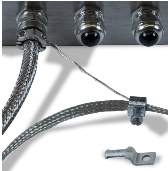
Figura 2-54: Alambre de fuga externo insertado a través de la abrazadera de conexión a tierra
