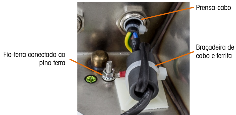
Figura 2-13: Localização original do cabo de energia
