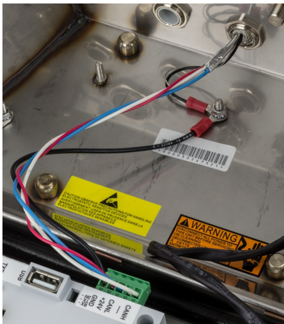
Figura 2-79: Armadietto per ambienti difficili PowerMount, cablaggio completato
